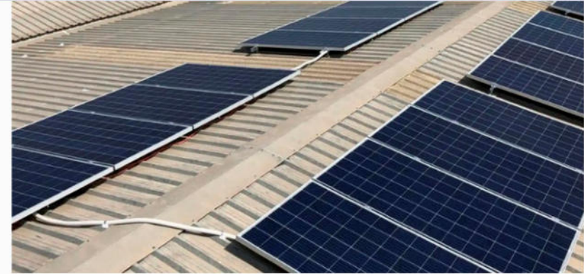
Unas placas solares en una nave industrial.
