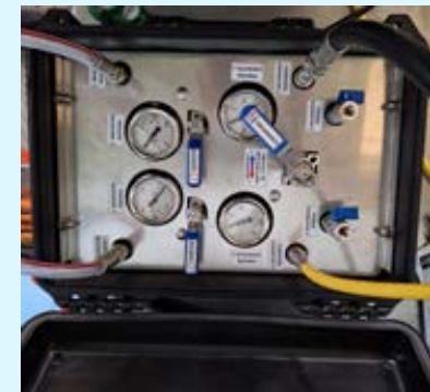
Cuadro de distribución de gases
