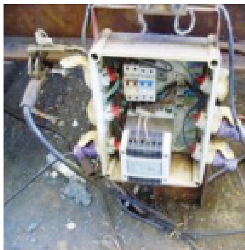
Foto 4: cadro eléctrico deteriorado
