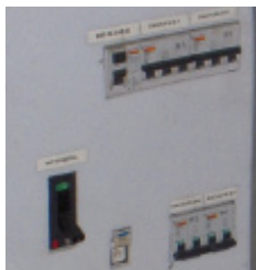
Foto 1: identificación dos elementos de mando-manobra
