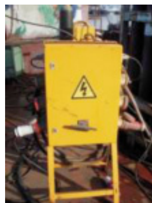
Fotos 2 e 3: cadros eléctrico protexidos
