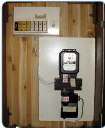
Panel illante detrás do contador
