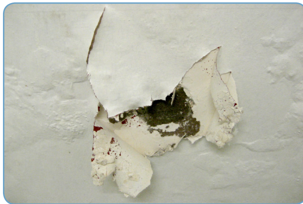
Pintura con amianto
