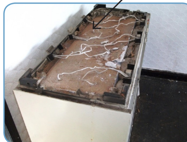
Amianto solto no interior dun radiador
