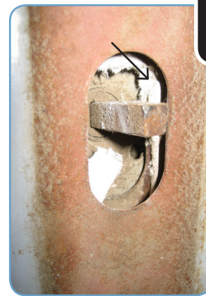
Interior de puertas cortafuegos
