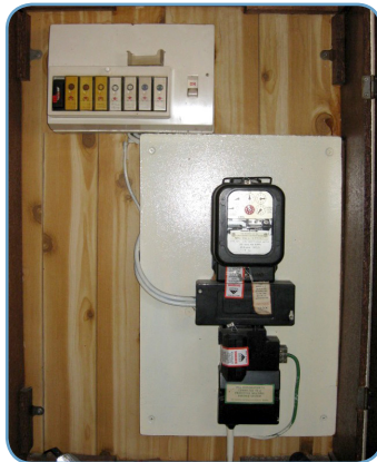
Panel aislante detrás del contador
