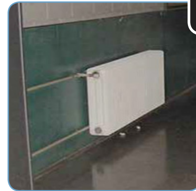
En pavimento y zócalo 1
