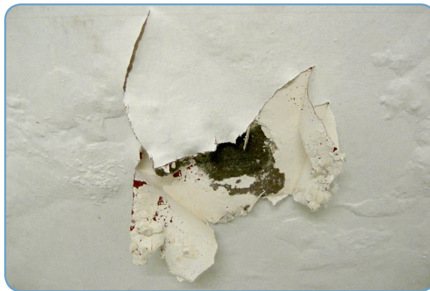
Pintura con amianto
