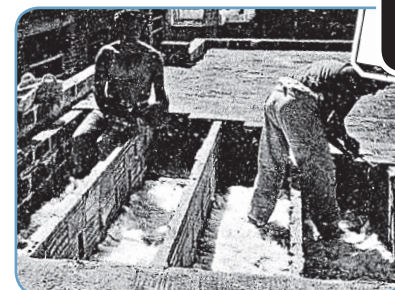
Amianto suelto en cámara de cubierta 1
