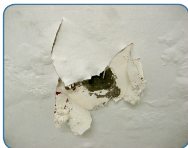
Pintura con amianto
