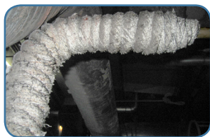
Corda trenzada (calorifugado)
