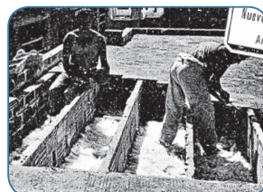
Amianto solto en cámara de cuberta 1
