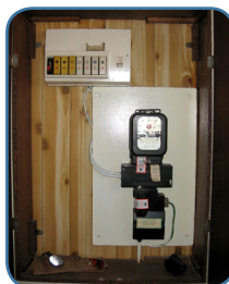
Panel illante detrás do contador
