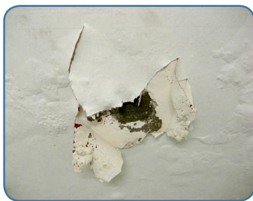
Pintura con amianto
