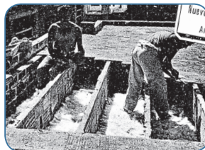
Amianto suelto en cámara de cubierta 1
