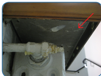
Panel aislante encima del radiador
